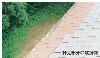
軒先部分の破損例
