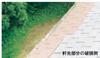
軒先部分の破損例
